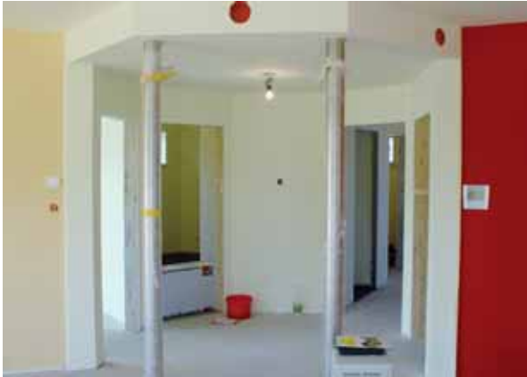
Bild 9: Harmonische Farbgestaltung im Innenbereich
